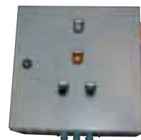
Armoire électrique de commande 0088-05 ou 0088-172
